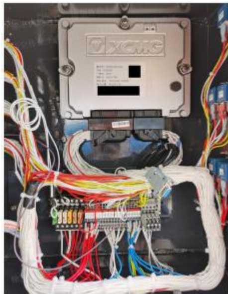
Fig. 5-10 Componenten in de schakelkast
