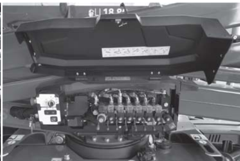
Fig. 87 Hydraulische bedieningen aan de grond
