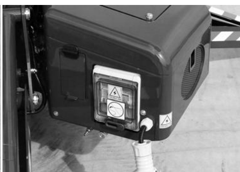
Fig. 85 Automatische magnetothermische schakelaar
