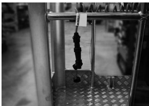
Fig. 157 Serviceaansluiting op hoogwerkerbak
