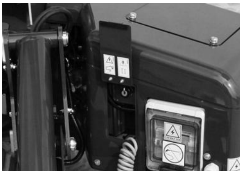
Fig. 134 Aansluitdoos in ruimte met elektrische componenten.
