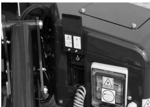
Fig. 129 Aansluitdoos in ruimte met elektrische componenten.
